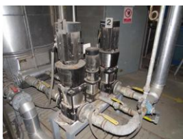
Referencia: SER-084 CONJUNTO DE BOMBAS Año: . Marca: .
