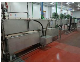
Referencia: TVE-038 TUNEL DE LAVADO Y SECADO Año: . Marca: .
