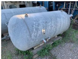
Referencia: CCM-028 DEPOSITO DE ACUMULACION Año: 1992 Marca: X-PAUCHARD
