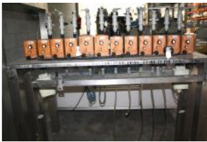
Referencia: BPS-066 GRUPO DE BOMBAS Año: . Marca: PROMINENT
