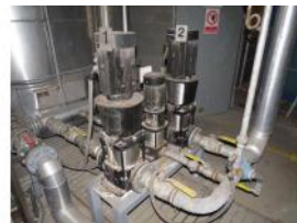
Referencia: SER-084 CONJUNTO DE BOMBAS Año: . Marca: .
