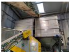
Referencia: MZA-007 TOLVA DE ALMACENAMIENTO Año: 2018 Marca: .
