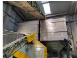
Referencia: MZA-008 TOLVA DE ALMACENAMIENTO Año: 2018 Marca: .
