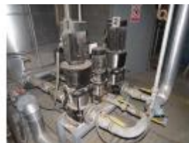
Referencia: SER-084 CONJUNTO DE BOMBAS Año: . Marca: .
