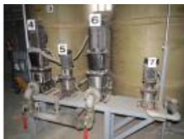
Referencia: SER-083 CONJUNTO DE BOMBAS Año: . Marca: .
