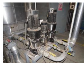
Referencia: SER-084 CONJUNTO DE BOMBAS Año: . Marca: .
