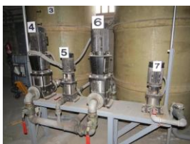
Referencia: SER-083 CONJUNTO DE BOMBAS Año: . Marca: .
