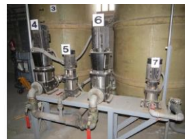
Referencia: SER-083 CONJUNTO DE BOMBAS Año: . Marca: .
