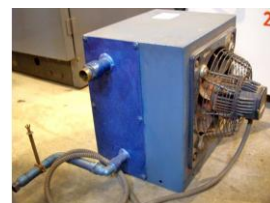
Referencia: BUS-006 REFRIGERADOR AIRE-AGUA Año: . Marca: AIRSEC
