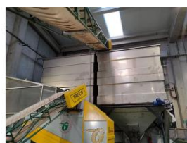
Referencia: MZA-007 TOLVA DE ALMACENAMIENTO Año: 2018 Marca: .
