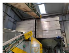
Referencia: MZA-007 TOLVA DE ALMACENAMIENTO Año: 2018 Marca: .
