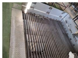
Referencia: MZA-002 TOLVA DE RECEPCION Año: 2018 Marca: .
