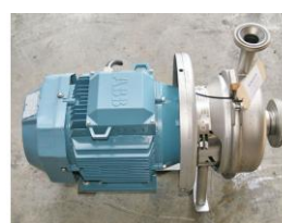
Referencia: SUN-051 BOMBA CENTRÍFUGA Año: 2005 Marca: APV
