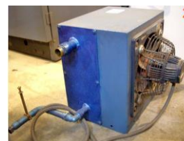
Referencia: BUS-006 REFRIGERADOR AIRE-AGUA Año: . Marca: AIRSEC
