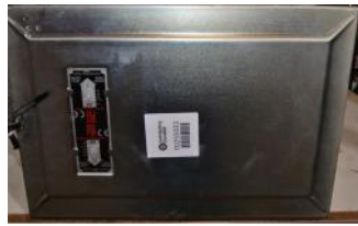
Referencia: BPS-146 SECCIONADOR O INTERRUPTOR GENERAL Año: . Marca: PPEF
