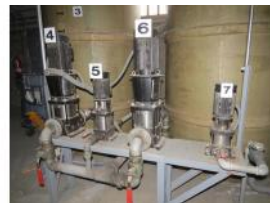
Referencia: SER-083 CONJUNTO DE BOMBAS Año: . Marca: .
